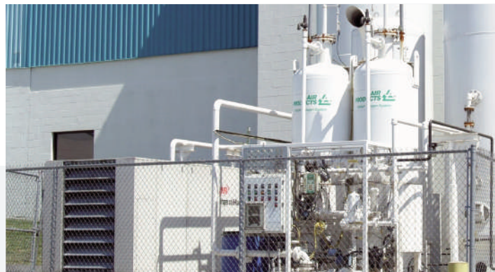
En el país ya están funcionando unos 250 equipos, aproximadamente.
