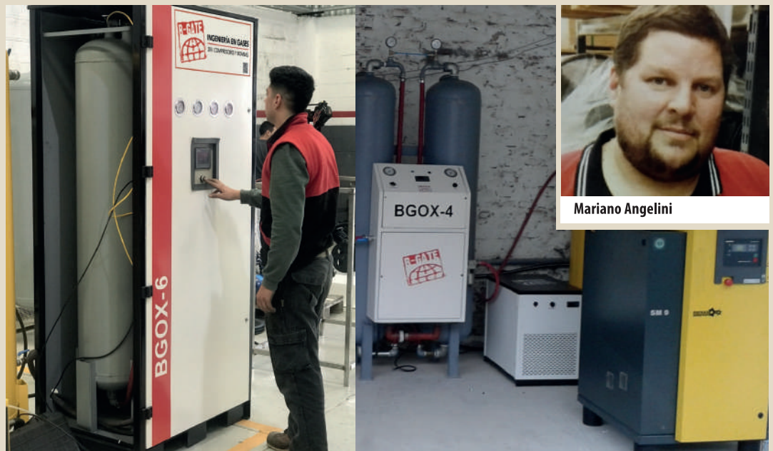
La firma del sur bonaerense suma el mantenimiento de los diferentes equipos PSA que hay en hospitales públicos provinciales.
